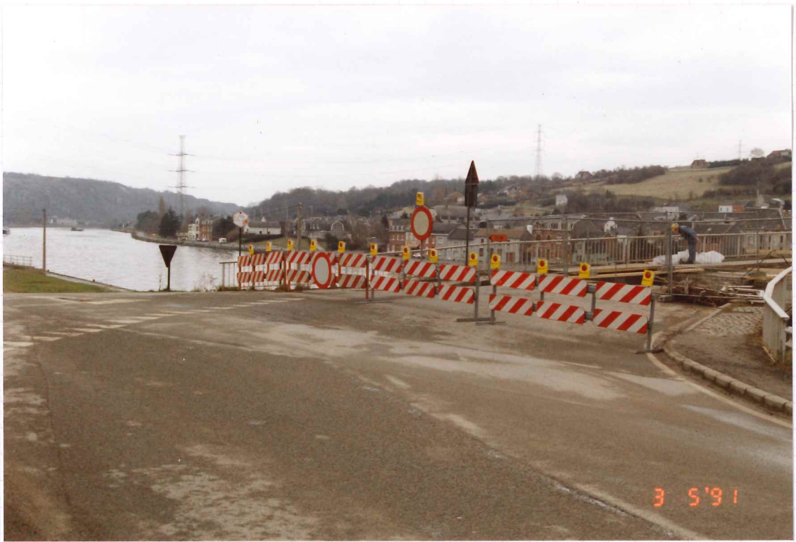
Fermeture du Pont côté VEZIN.
