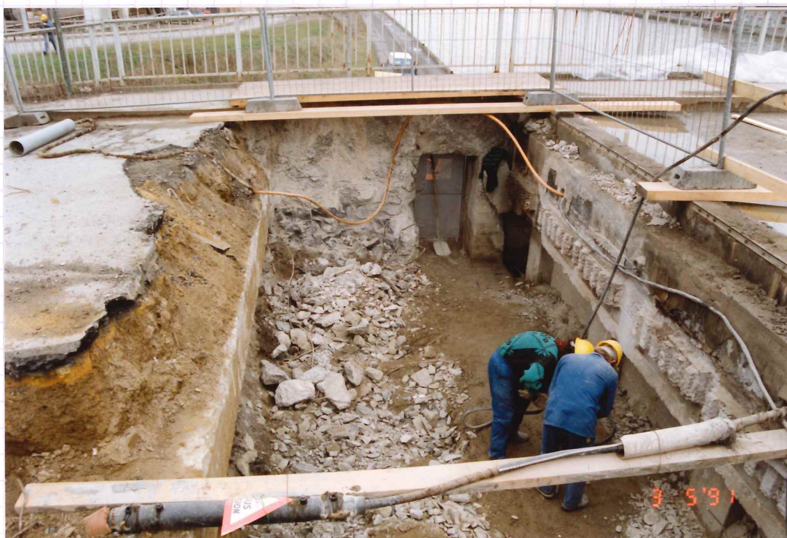
Découpage du Béton à l'arrière (extrémité) des palles de Précontrainte. A l'avant plan sur la Poutrelle le palle A.L.E. 16.000 Volts.
