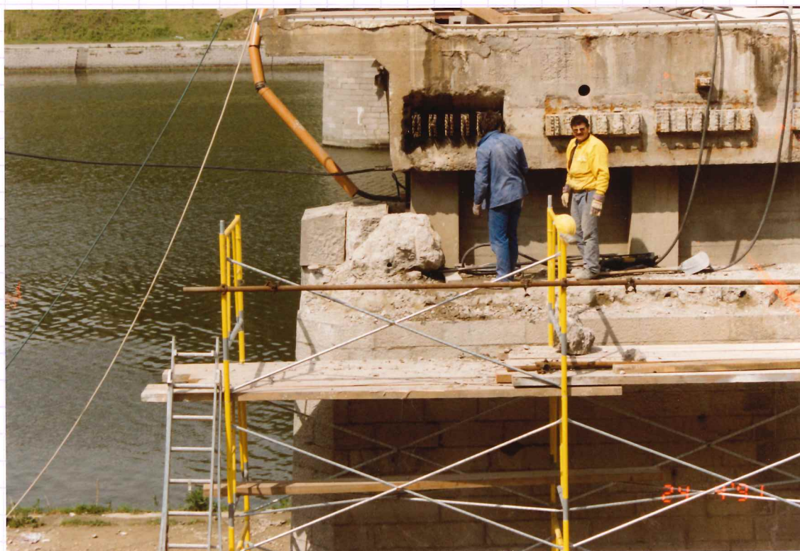
Culée pile droite: (Huse) Délevement et dégageement de la plaque d'ouvrage par son amont 1 er groupe.
