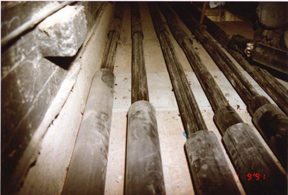
ZONE de disposition des manchons entre la gaine se trouvant dans le pont et la gaine se trouvant fixée à la plaque d'aufrage. Celle-ci traverse le boe d'about et est bloquée dans ce dernier par un mortier qui se rétracte.
