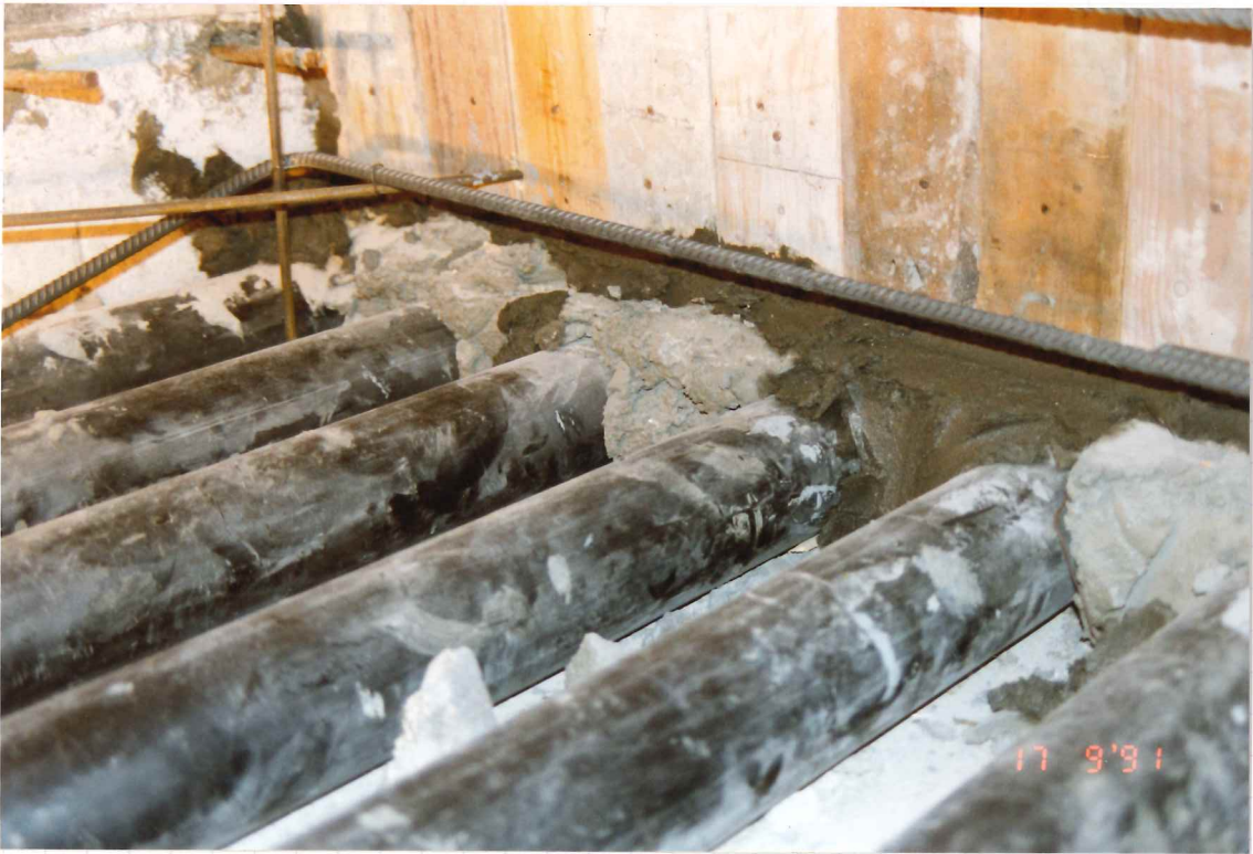
colmatage autour des gaines à l'enduit du coffrage vertical.
