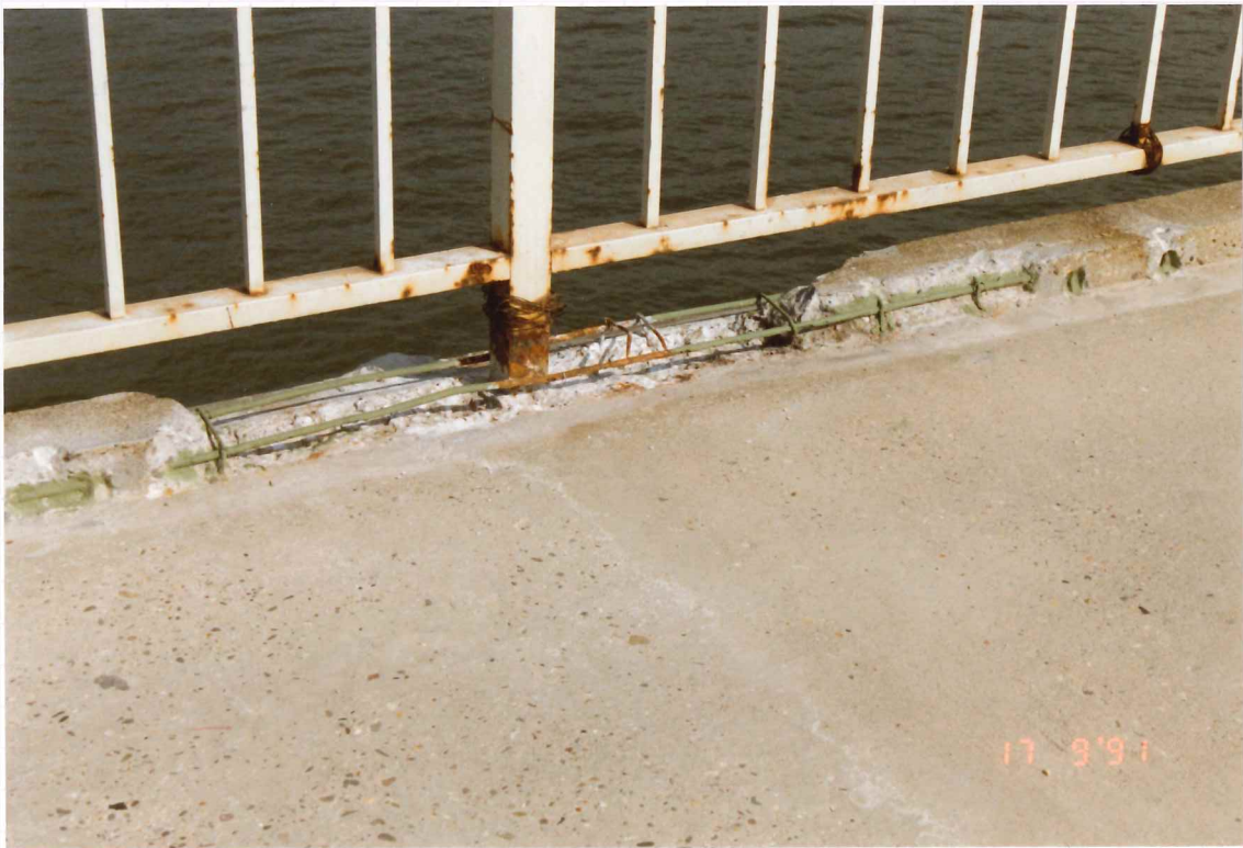
On distingue en vert la poutre de Protection contre la rouille.
