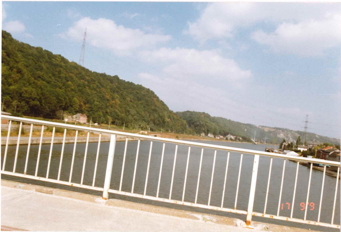
Vue d'ensemble côté aval. Vue également du pied du garde corps décapé et où l'on voit la rouille.
