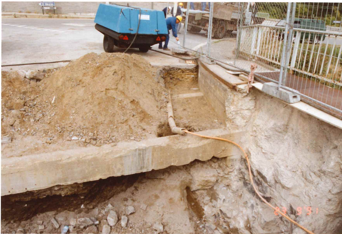
Culée rive gauche. Poche Birau entre les murs en béton. Travail manuel autour du Collo RTT.
